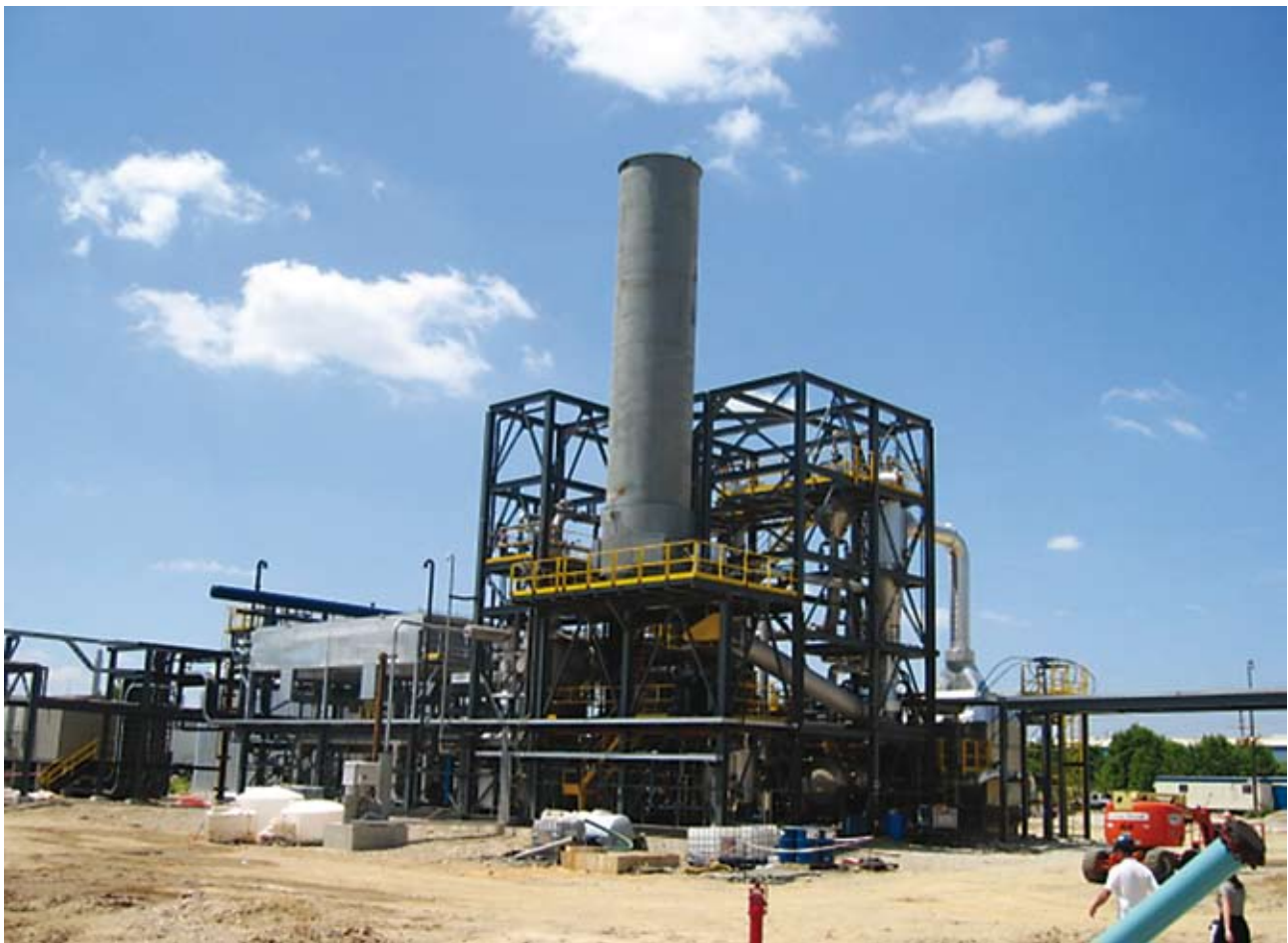
Figur 10: Eksempel på produksjonsanlegg (Dynamotive, 2010)
